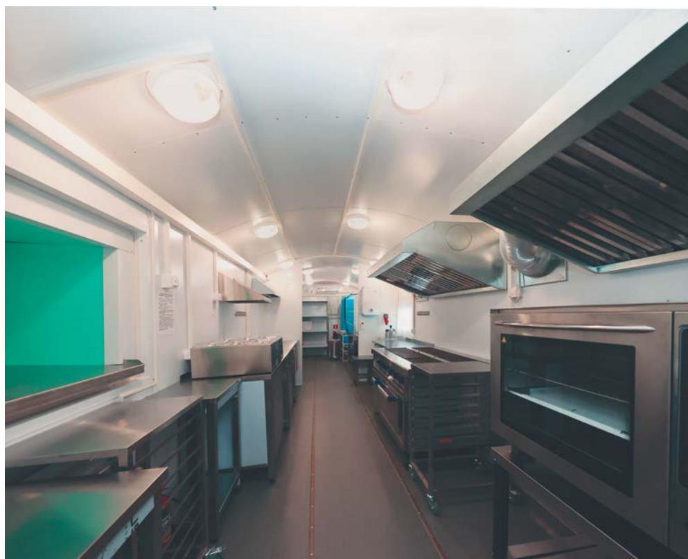
Кухня оснащена современным технологическим оборудованием
